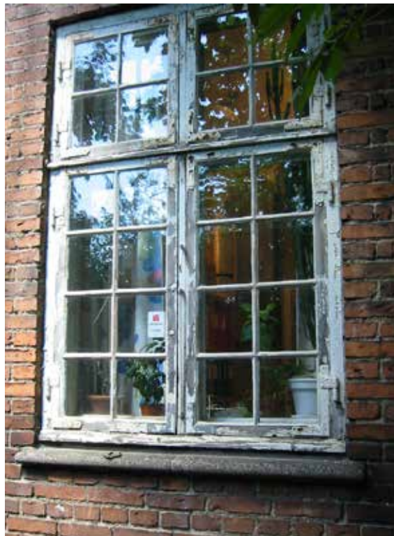
Slem ser det ud – store afskalninger, rust, løsnede beslag og blødt træ. Men gamle vinduer er i en solid trækvalitet, så selve det bløde træ kan godt sættes i stand og blive hårdt og vandafvisende igen med brug af linolie og linoliemaling.
