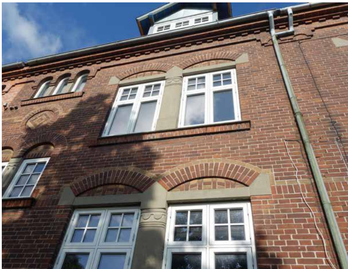
Kedelig vinduesudskiftning med nye termovinduer på et ellers pænt og velbevaret historicistisk byhus. De dybtliggende ruder med uhyggelige spejlinger forringer husets bevaringsværdier, men disse kan genetablerses, næste gang vinduerne skiftes, hvor man kan isætte vinduer magen til de oprindelige med ægte sprosser i kitfals og trukket glas.
