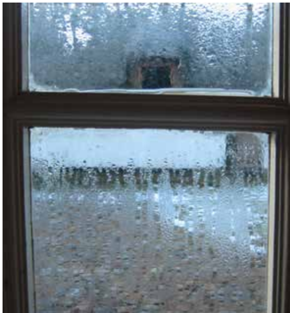
På uisolerede gamle vinduer, uden forsatsrammer, kondenser rumfugten på de kolde ruder, så vandet driver ned ad vinduerne. Det er ikke noget kønt syn eller særlig sundt.
