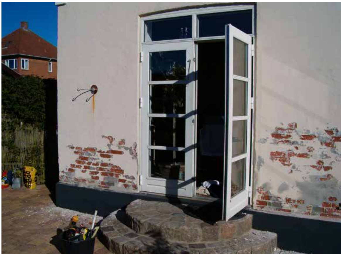
Kraftige frostafsprængninger af plastikmalet puds – formentlig p.g.a. sammensunket, våd efterisolerings-granulat nederst i hulmuren. En skal af murstenene følger også med. Her er der allerede repareret tre gange med pæne omkostninger og et nedslående resultat. Der er næppe heller nogen særlig varmebesparelse at glæde sig over.
