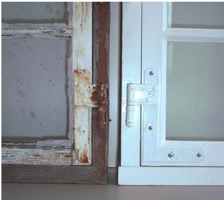
Vindue (til højre) malet med linoliemaling med zinkhvidt
