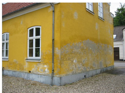
Sokler på murede fundamenter må ikke pudses med mørtel indeholdende portlandcement eller overfladebehandles med stenkulstjære eller sokkelasfalt. Begge dele er alt for tætte og medfører at fugten trænger meget højere op i murværket. Her næsten 1,5 meter.
