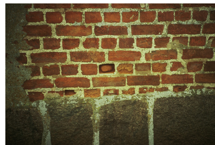
Mursten er et særdeles robust materiale, der tåler al slags vejr og vind, hvortil kommer, at det kan holde stort set uden vedligeholdelse i hundreder af år. Men salte kan fuldstændigt pulverisere mursten. Tøsaltning og opsprøjt fra smeltet, tøsaltet sne/is er årsagen til dette.
