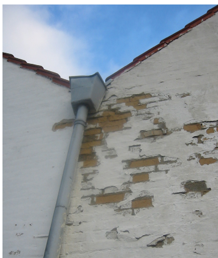
En utæt tagrende eller et utæt nedløbsrør afslører sig meget hurtigt med våde eller misfarvede pletter på facaden. Plasticmalingen holder yderligere på fugten, så murstenene frostsprænger.
