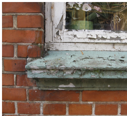
Revnet og forvitret sålbænk. Vinduet ser heller ikke for godt ud.
