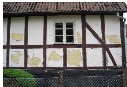
Plasticmalet bindingsværk. På de murede tavler kan man være så heldig at den alt for tætte plasticmaling 'ruller af', som her. Værre er det, hvis man har malet tømmeret med plasticmaling. Så rådner dette erfaringsmæssigt.
