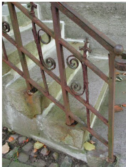
Rustne balustre af jern kan sprænge selv et så hårdt materiale som granit i stykker, hvis rusten får lov at udvikle sig. Pas især på med tørsaltning her.
