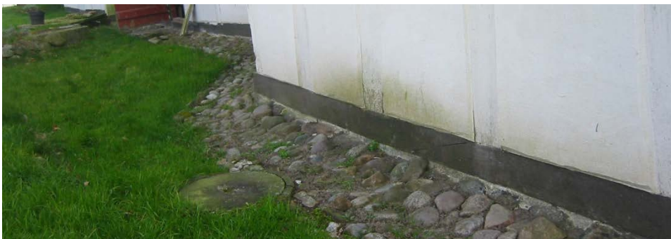
Rigtigt: Pigstenskant langs bindingsværksvæggens 'tagdryp' – men se lige hvad et lille betondæksel kan bevirke af fugt og grønalger på væggen. Det klarer pigstenene – der dog ikke må lægges i beton – meget bedre.
