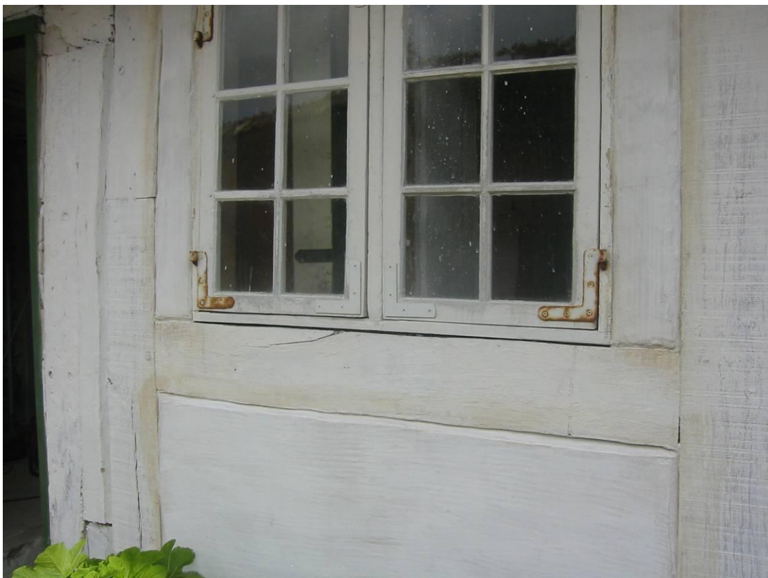
Vinduerne med forkerte vinduesbeslag.
